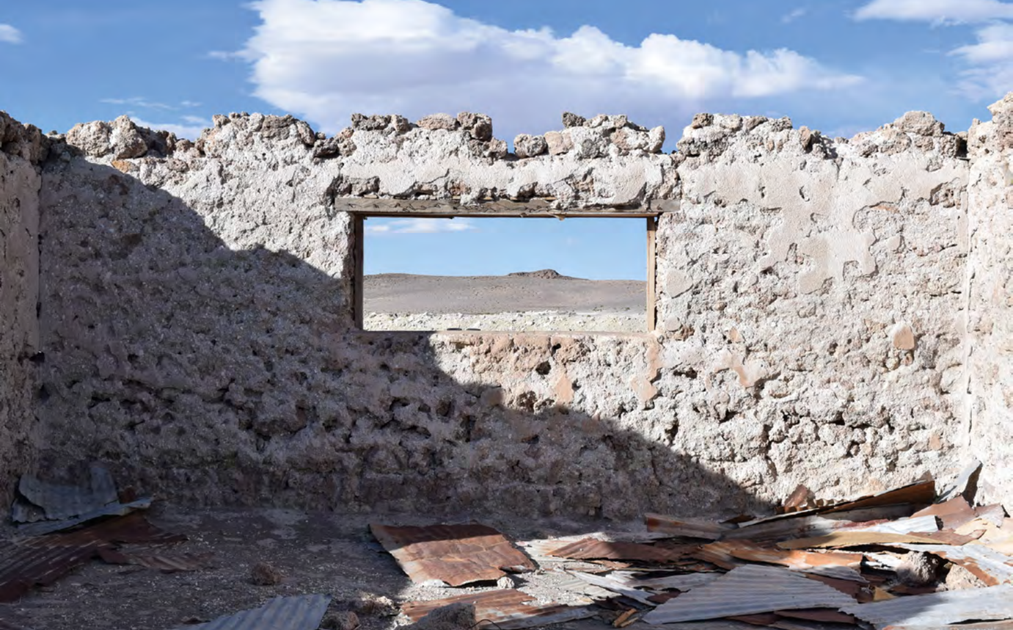
Figura 5. Buenaventura, habitación de trabajadores desmantelada.
