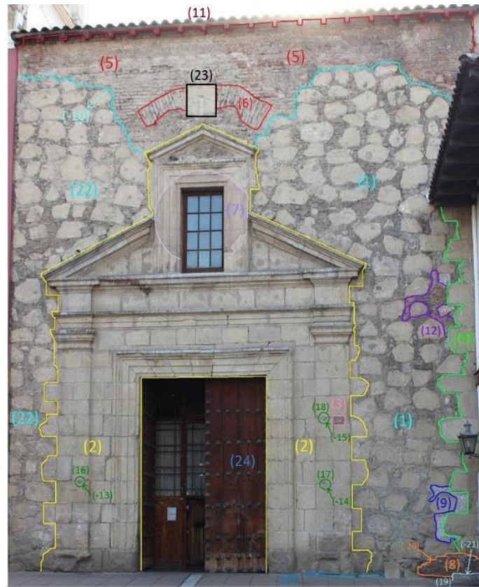
Figura 7. Zona 1 de la fachada de la iglesia con identificación de UEs.
